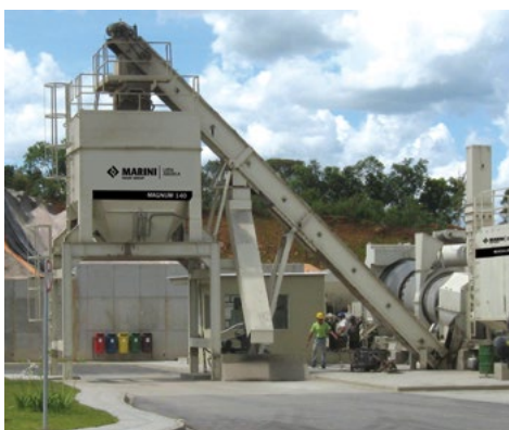
Silo fixo 25 m 3
