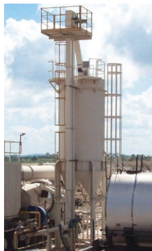
Sistema de coleta de finos com silo de 20 m 3
