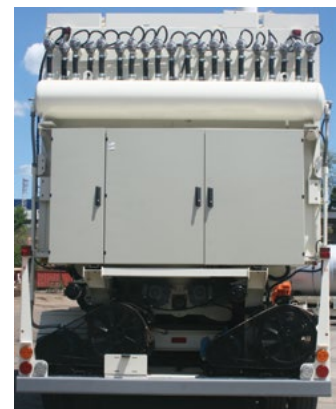
Quadro de força
